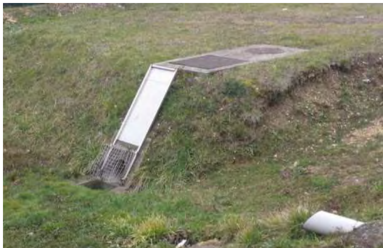
Ouvrage de régulation Société Zhendre à Villenave d'Ornon
