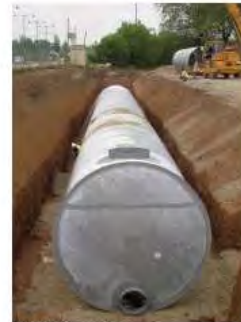
Canalisations de stockage en acier (source: tubanor)
